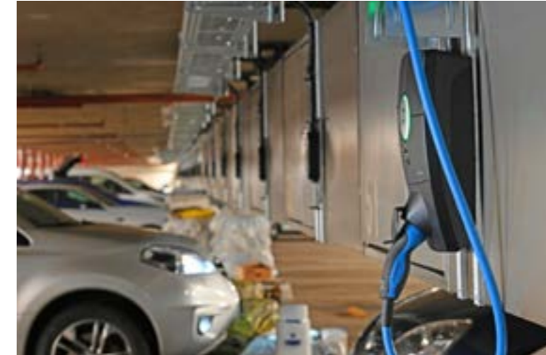
Ein Teil des PV-Stroms von den Dachflächen (ganz links) wird in der Einstellhalle zum Laden von Elektrofahrzeugen genutzt (links).
